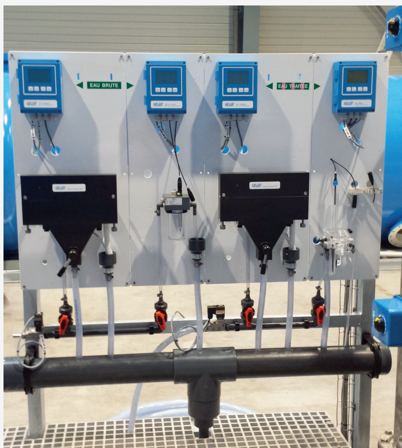
Instrumentation dédiée au contrôle automatisé de la qualité de l'eau. (turbidité sans contact, pH et chlore libre) ©SWAN
