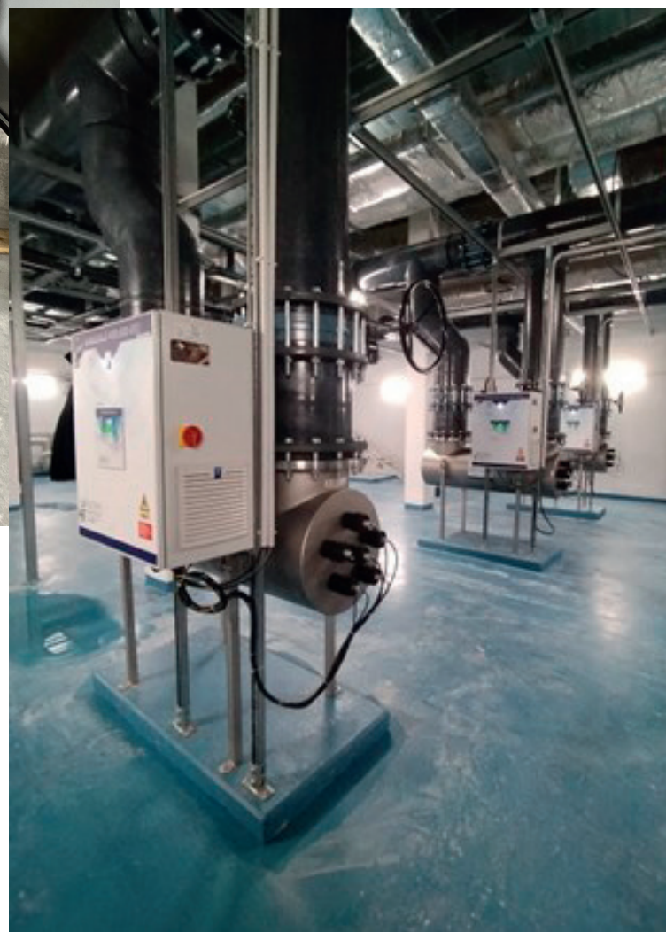
Déchloramineur UVDECHLO d'une piscine olympique. 550 m³/h par appareil. ©UVgermi
