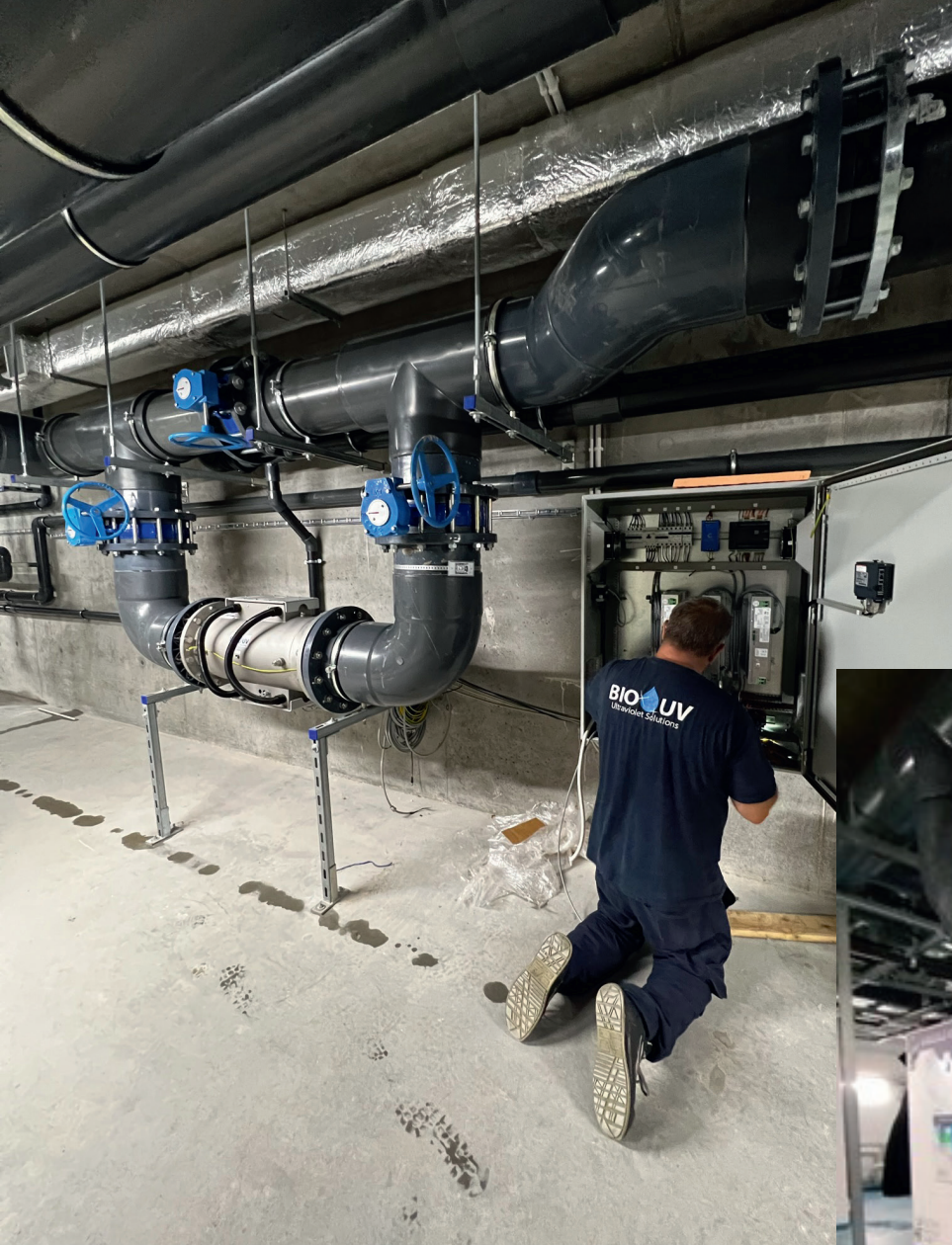
Exemple de maintenance sur une armoire électrique de déchloramineur UV. ©BIO-UVgroup
