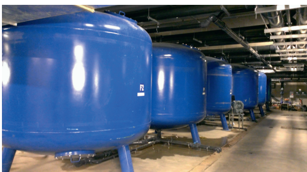
Exemple d'une salle de filtration dans un centre aquatique. ©Polymem
