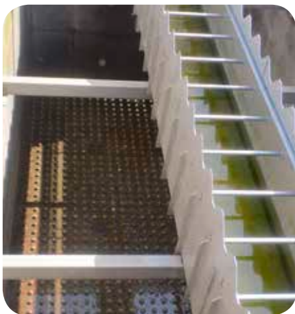
Filtre à charbon actif en grains (CAG)
